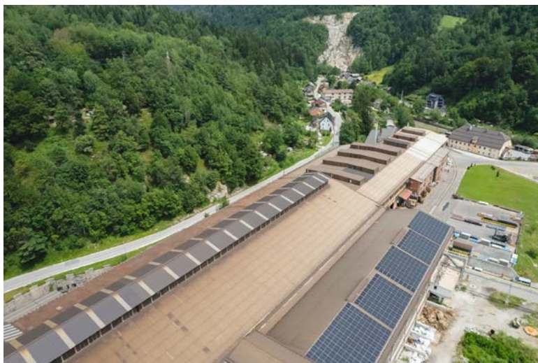
Sončna elektrarna družbe SIJ Acroni na strehi hale C obrata PDP. Sončne žarke lovi 405 sončnih kolektorjev.
